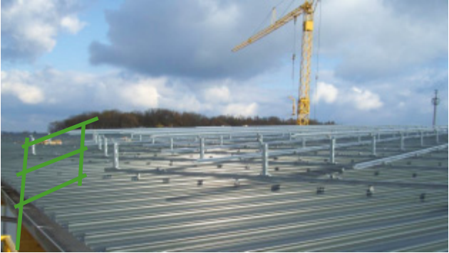
Aufstieg über Hubarbeitsgerät nur mit Absturzsicherung
