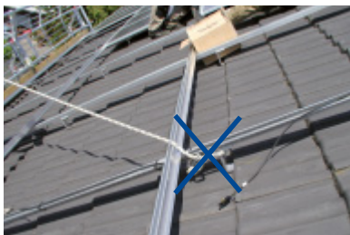
Unsicherer Anschlagpunkt an dem Gestell
