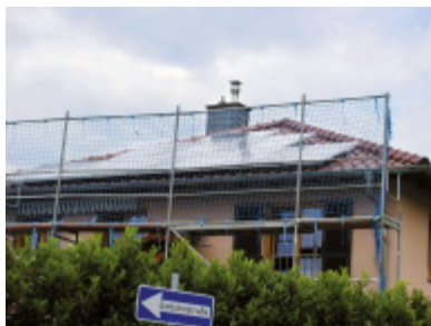
Fangerüst mit über den Arbeitsbereich hinausreichendem Fangnetz
